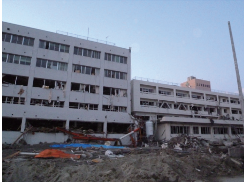
写真1. 津波で4階までが流出した公立志津川病院
